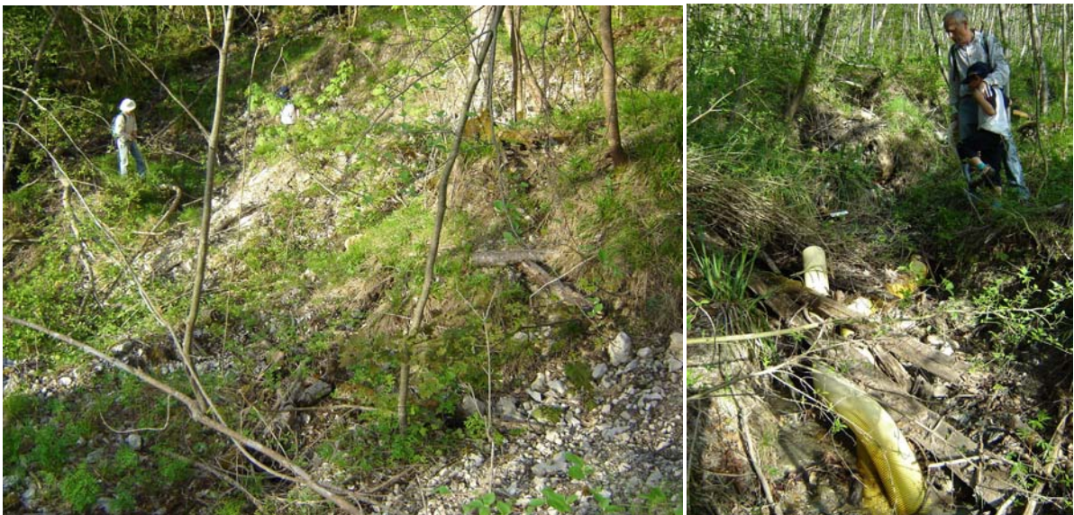
Abb. 7a, b: Rutschung durch Wasserinfiltration an einer für den Drainagerohreinbau neu angelegten Stichstraße (links), Nicht mehr funktionelle und völlig zerstörte Drainagerohre (rechts) im aktiven Bereich des Gschlifegraben (Foto: J.T. Weidinger/W. Vortisch 2005).
